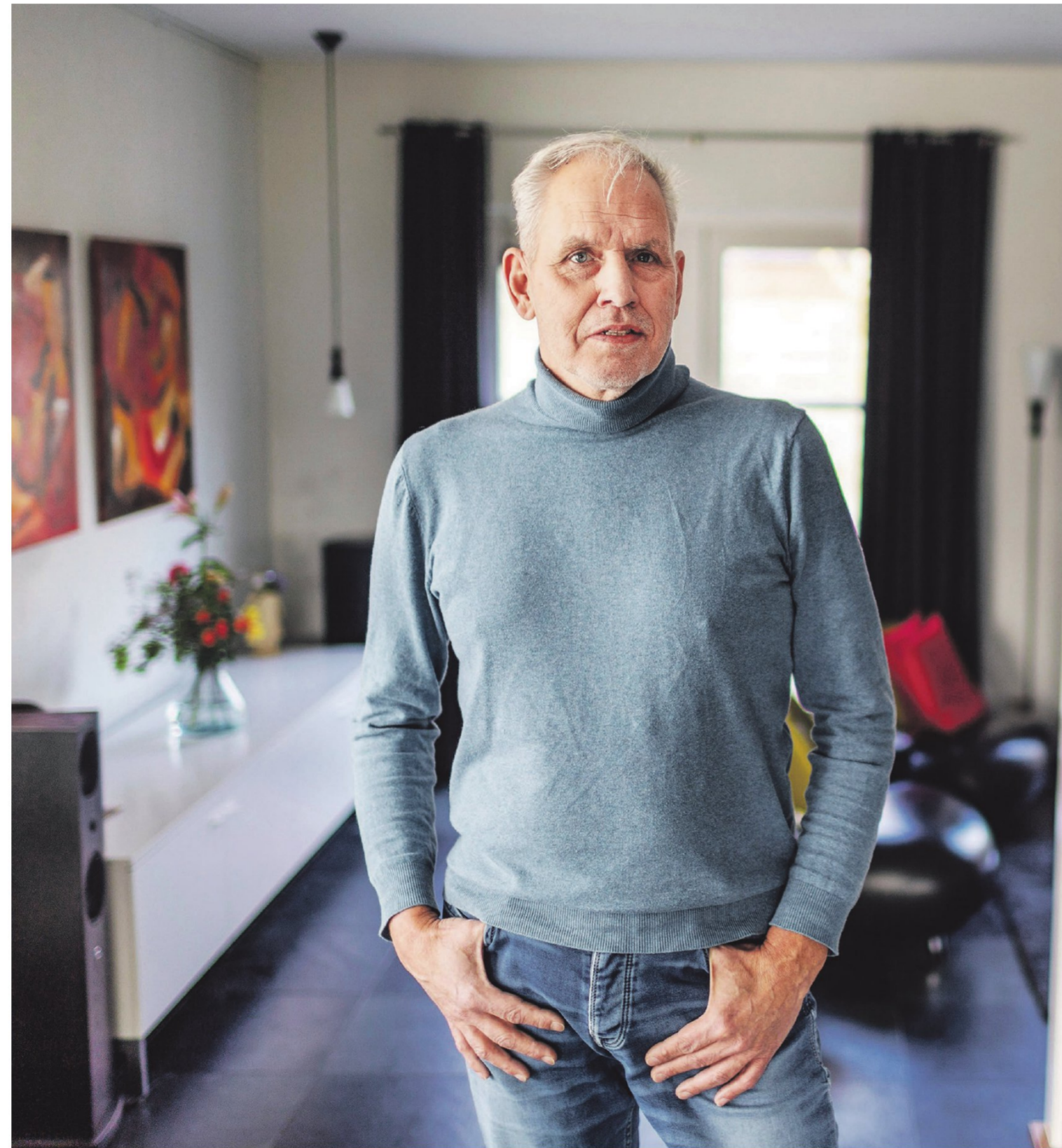
Hans Kluitenberg heeft op de eerste verdieping van zijn woning in Kampen naast elkaar een cv-installatie en een warmtepomp staan.
